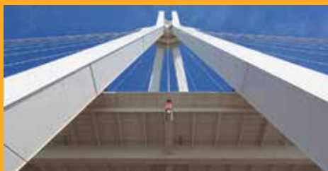
ZAŠČITA PRED KOROZIJO
