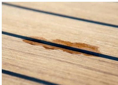
Sl. 32 Obarvan del tikove deščice v območju poškodovane fuge
