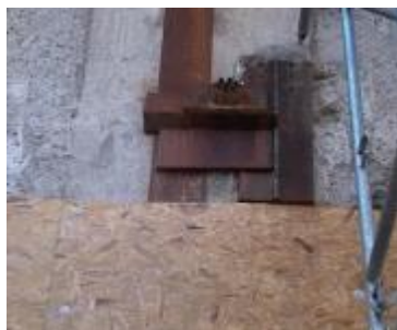
Sidrišče varovanja gradbene jame (ni enotne in ravne površine)
